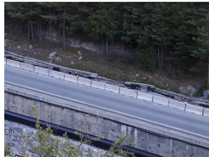
Photographie 25 : Section de la RD 947 touchée par le glissement du Pas de l'Ours
