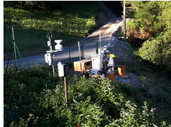
Photographie 24 : Système de surveillance du glissement de terrain
