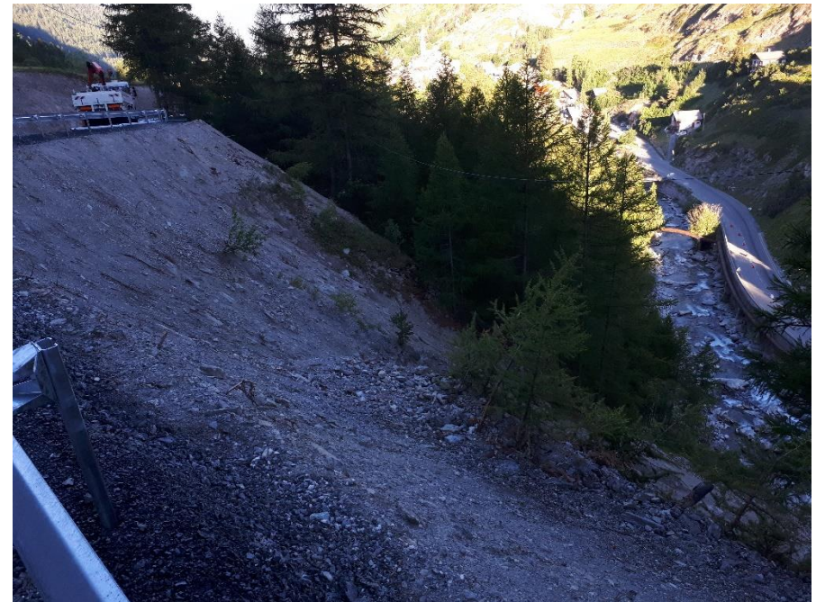
Photographie 10 : Zone à fort dénivelé entre la nouvelle piste de secours et la RD 947 au niveau de la zone menacée
