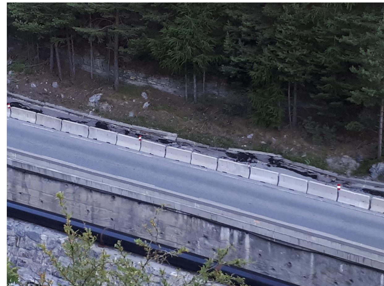
Photo 5. Glissement de terrain sur la RD947
